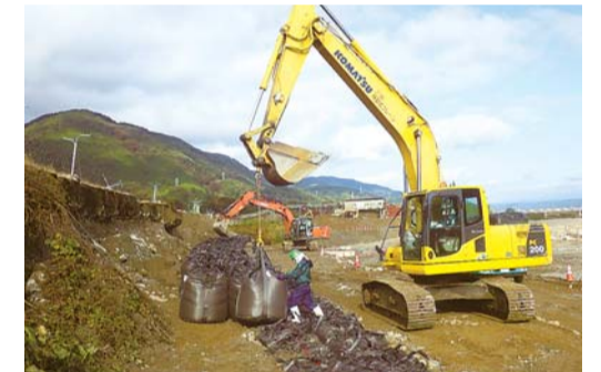
山梨県建設業協会による釜無川護岸の大型土のう搬入
