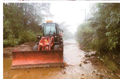
神奈川県建設業協会による箱根地区の災害対応(提供・三和建設)
