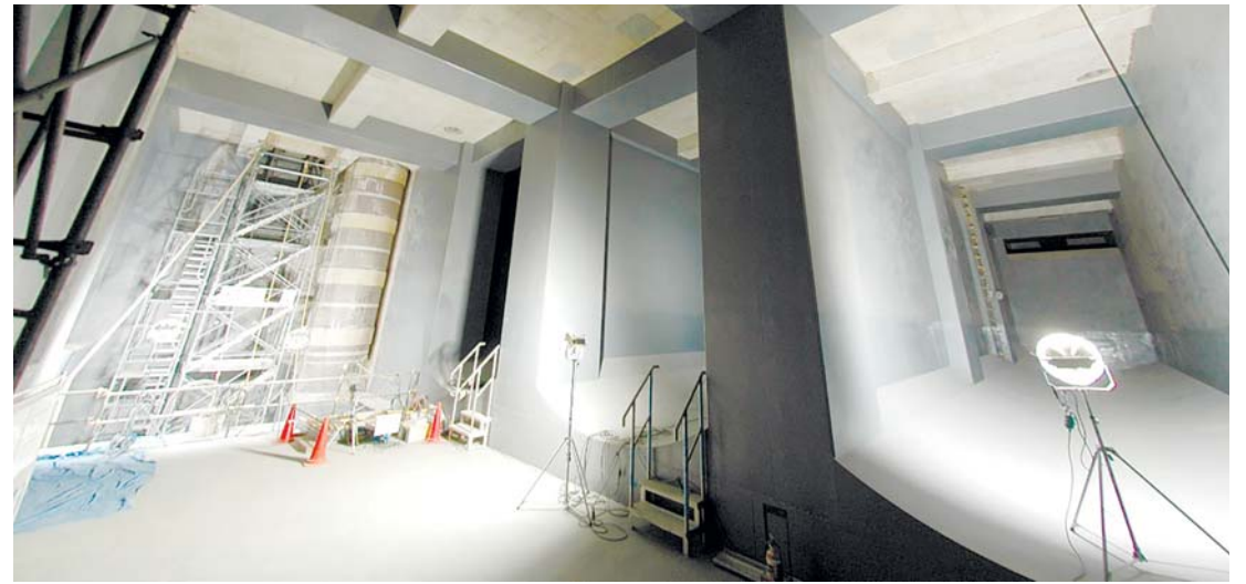
渋谷駅東口広場の地下に整備した雨水貯留施設の内部
