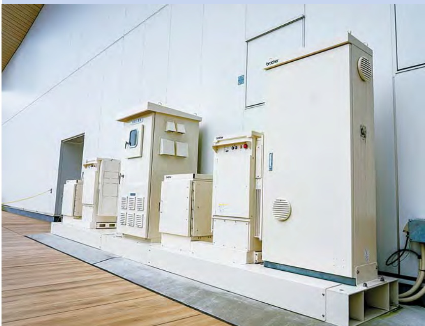
純水素燃料電池システム
