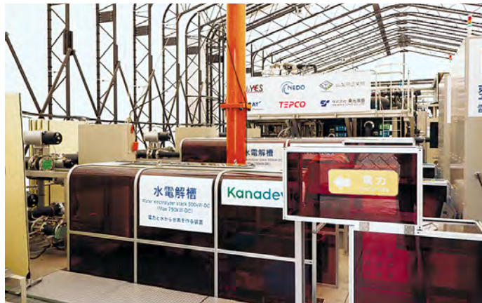
米倉山のP2G実証研究棟
